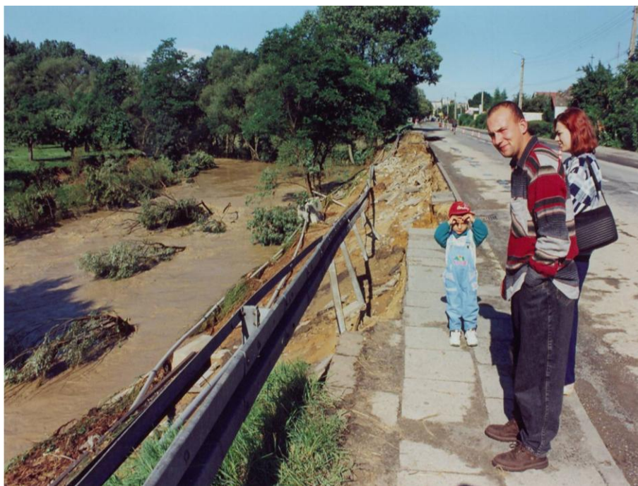
Fot. 9. Podmyta droga krajowa nr 4 w Brzesku (zbiory UM Brzesko)
